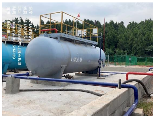
废水罐及围堰
