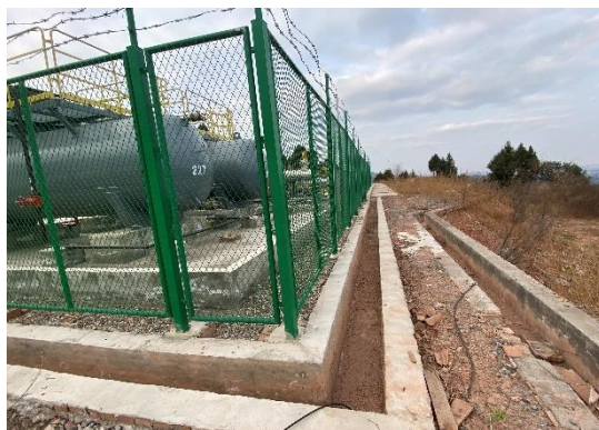
清污分流：采气井场排水沟
