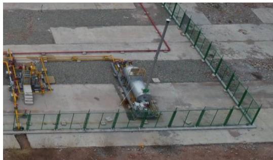
水套炉自带排气筒
