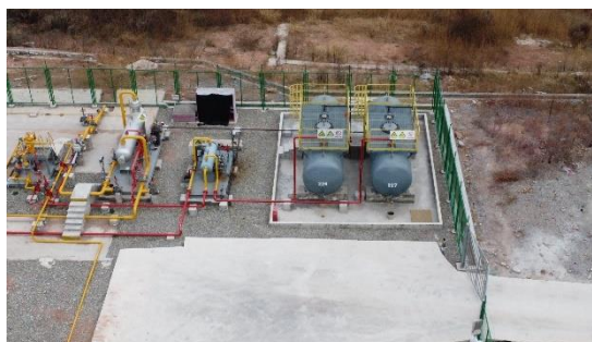
分离器、污水罐及围堰
