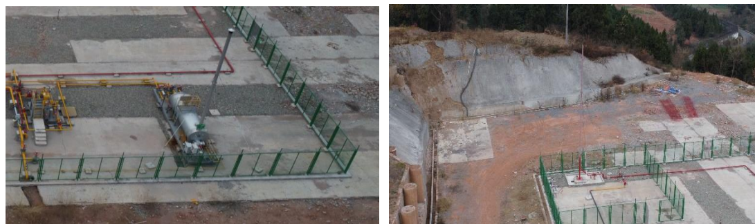
水套炉自带排气筒
