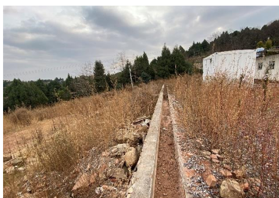
清污分流：钻井井场排水沟
