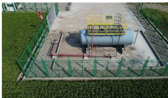
污水罐及围堰
