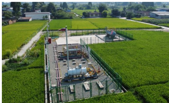
水套炉自带排气筒
