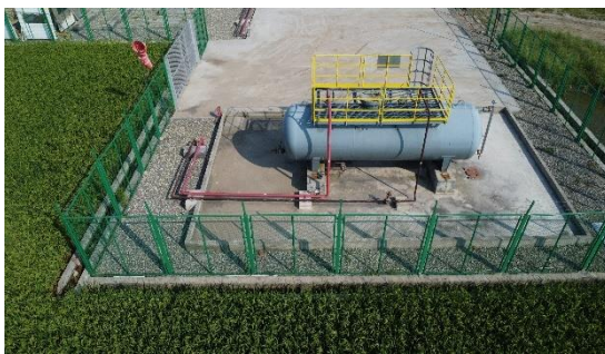
污水罐采取了防渗并设置围堰
