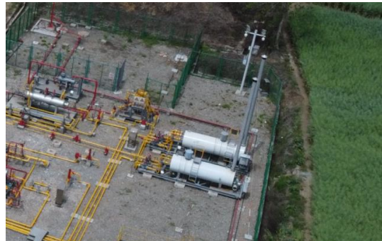
水套炉自带排气筒
