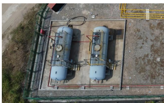
污水罐采取了防渗并设置围堰
