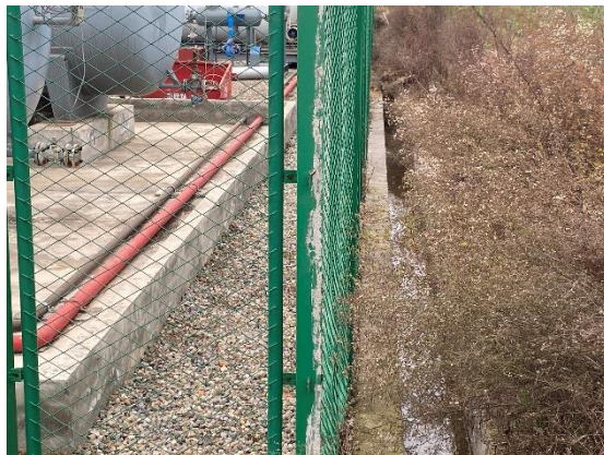
采气井场设置了排水沟
