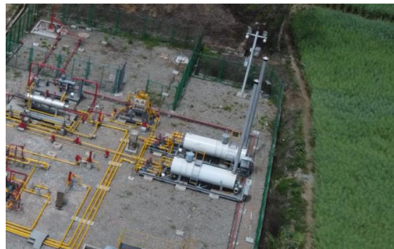
水套炉自带排气筒
