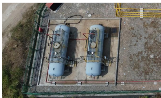
污水罐采取了防渗并设置围堰
