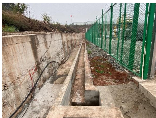
截排水沟及集污坑
